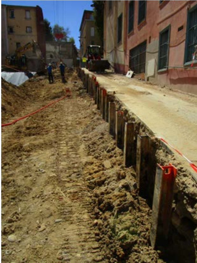
Mise en place de la paroi berlinoise le long de la rue Côte Saint-Sauveur, avant de réaliser le décaissé du futur bâtiment.
